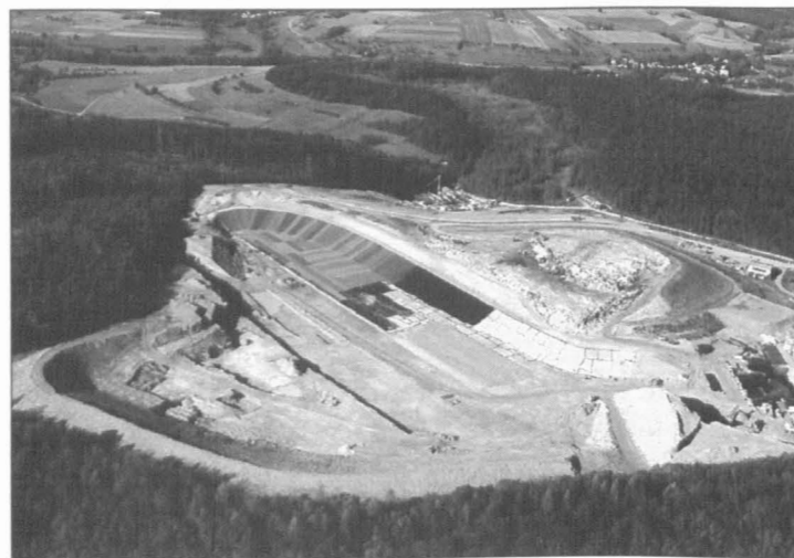
Zu den großen Projekten der Firma Backes im Saarland zählt die Deponie in Merzig-Fitten.
